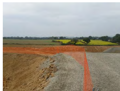
Figure 260 : Autre exemple filet de chantier.
